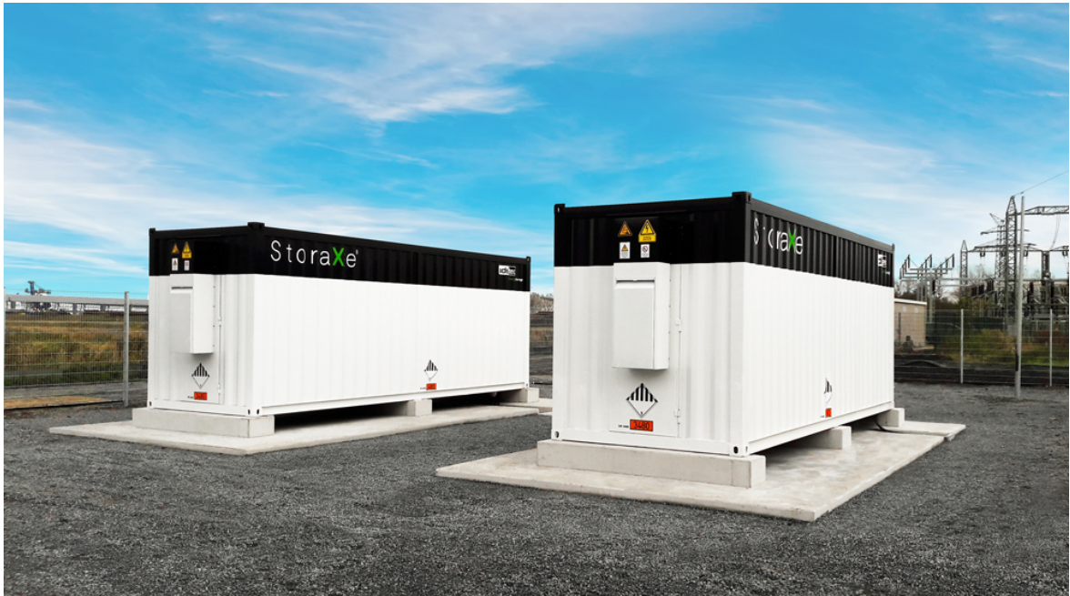
Neuer Großspeicher mit 2,5 Megawatt Leistung am Standort der Wind to Gas Energy GmbH & Co. KG in Brunsbüttel. Foto: ADS-TEC
